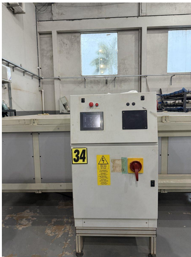
Fotografia 07 — Painel de comando de linha de processamento (forno/laminação)
