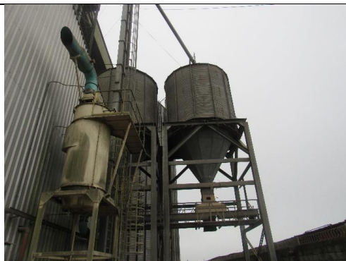
Silos de expedição e filtro de mangas
