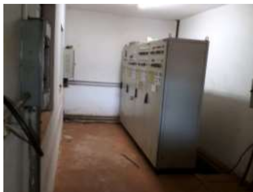
Sala/Quadro de Comandos
