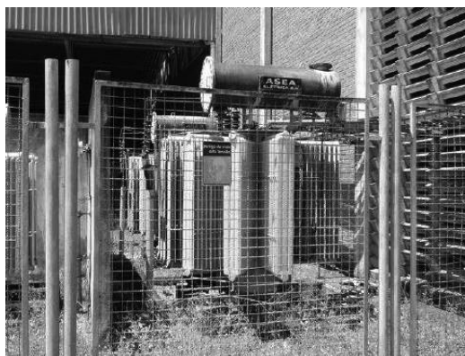
NR 1934 - TRANSFORMADOR A ÓLEO POT. 2000 KVA +556-557
