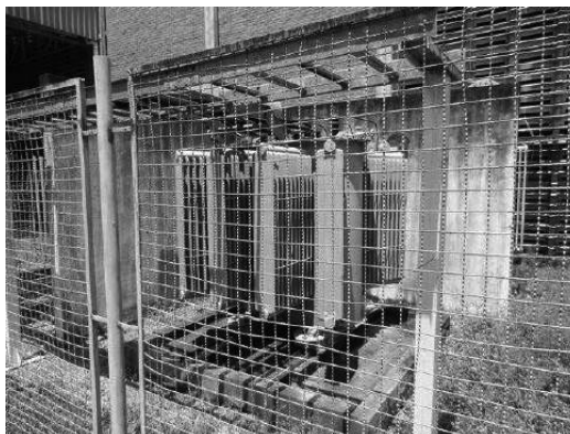
TRANSFORMADOR A ÓLEO POT. 750 KVA ASEA ELETRICA S/A
