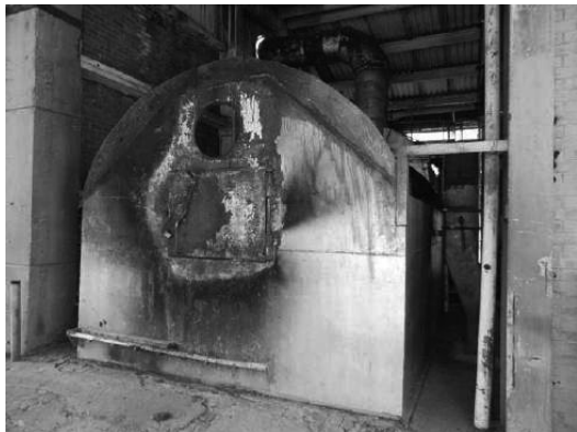
CALDEIRA DE VAPOR A LENHA CAP. 12.000 KG/H CONSERVIT
