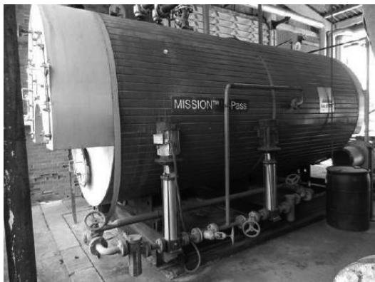
NR 1212 - CALDEIRA DE VAPOR A ÓLEO CAP: 5.000 kg/h AALBORG INDUSTRIES
