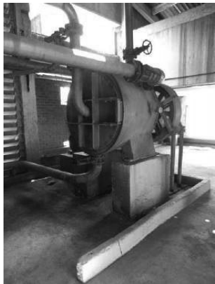
NR 810 - DEPURADOR FIBER SORTER VOITH FS2B
