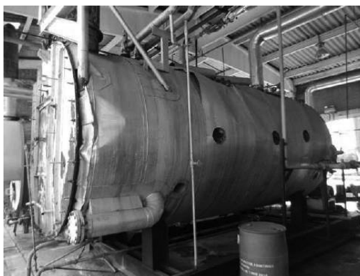
NR 1214 - CALDEIRA DE VAPOR A ÓLEO CAP: 9.000 kg/h CBC
