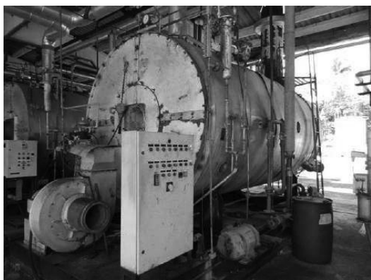
NR 1214 - CALDEIRA DE VAPOR A ÓLEO CAP: 9.000 kg/h CBC
