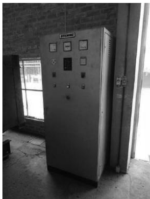
NR 1131 - GRUPO GERADOR MOTOR CUMMINS CAP: 440KVA CUMMINS
