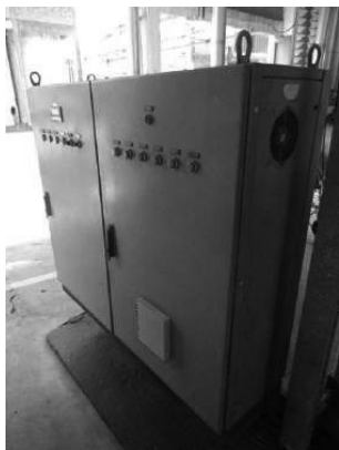
NR 1212 - CALDEIRA DE VAPOR A ÓLEO CAP: 5.000 kg/h AALBORG INDUSTRIES
