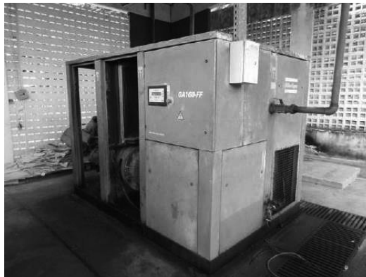
NR 761 - COMPRESSOR DE AR ATLAS COPCO GA 160
