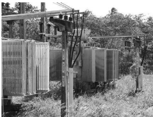
NR 2087 - TRANSFORMADOR A ÓLEO POT. 5.000 KVA ASEA ELETRICA S/A
