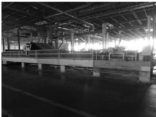
NR 1244 - MESA DE SECAGEM DA ONDULADEIRA TOMASONI
