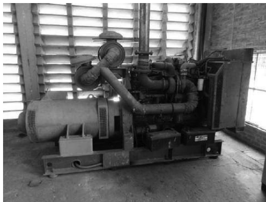
NR 1131 - GRUPO GERADOR MOTOR CUMMINS CAP: 440KVA CUMMINS
