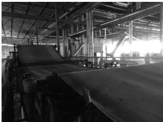
NR 1244 - MESA DE SECAGEM DA ONDULADEIRA TOMASONI
