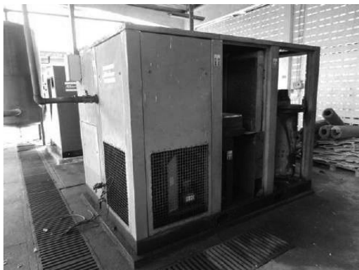
NR 761 - COMPRESSOR DE AR ATLAS COPCO GA 160
