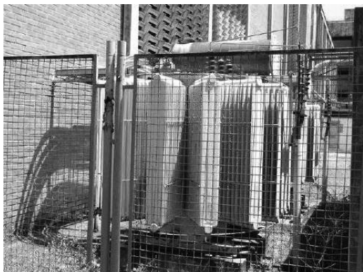
TRANSFORMADOR A ÓLEO POT. 2.000 KVA
