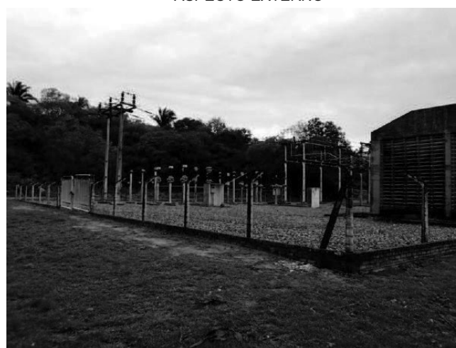
SUBESTAÇÃO 02 ASPECTO EXTERNO
