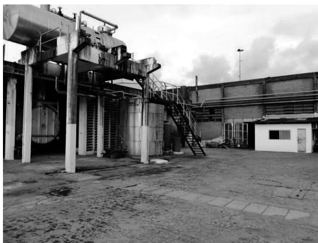
CALDEIRAS ASPECTO EXTERNO
