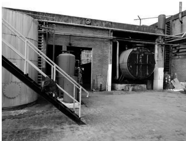
CALDEIRAS ASPECTO EXTERNO
