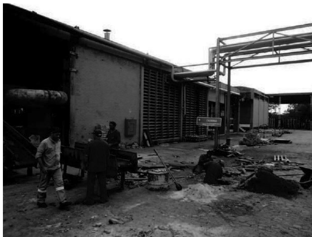
CALDEIRAS ASPECTO EXTERNO
