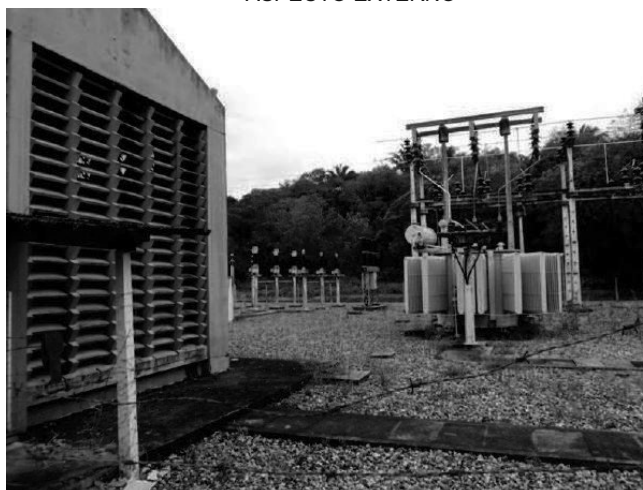
SUBESTAÇÃO 02 ASPECTO EXTERNO
