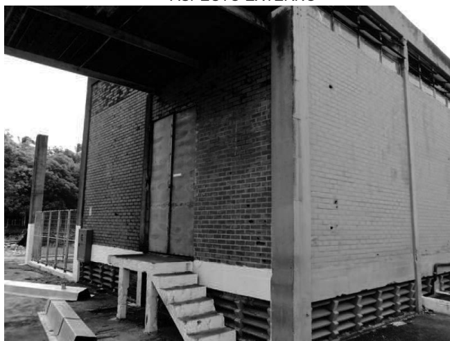
SUBESTAÇÃO 01 ASPECTO EXTERNO
