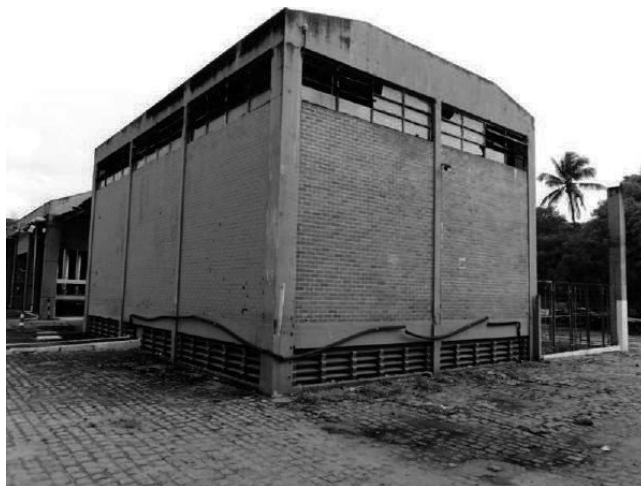
SUBESTAÇÃO 01 ASPECTO EXTERNO
