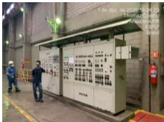
Fabrica/Quadro de Comandos
