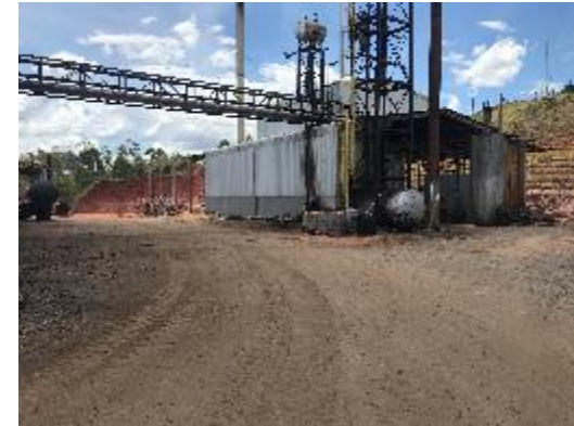
Caldeira para geração de vapor
