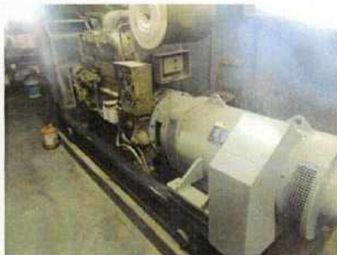
1248 – Gerador (CUMIS 368 KVA)
