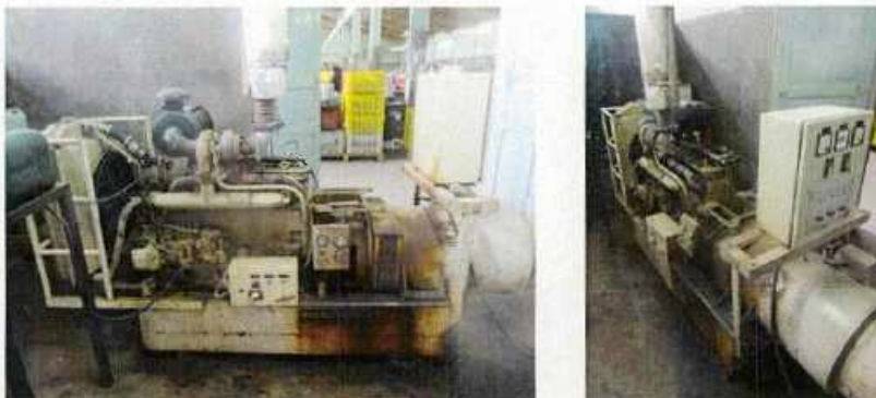
54 - Gerador de eletricidade (MWM)
