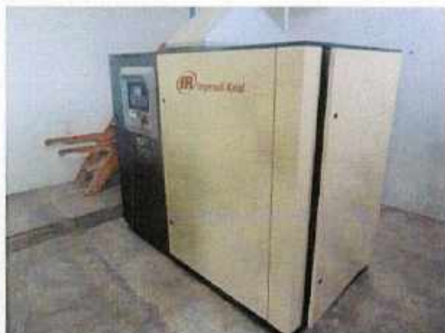
59 - Compressor de ar 02
