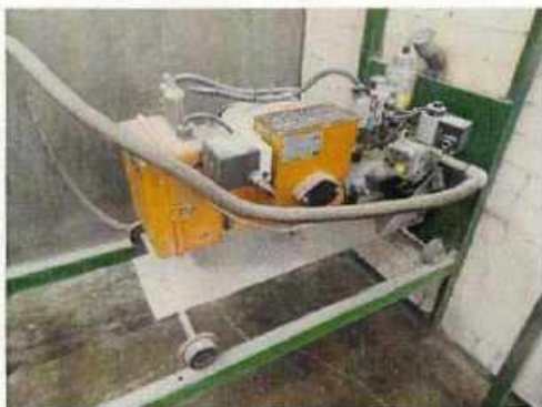
57 - Gerador de calor Baltur
