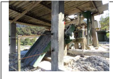
Estação de Tratamento de Efluentes
