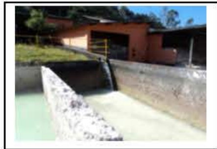
Processo de reciclagem de água
