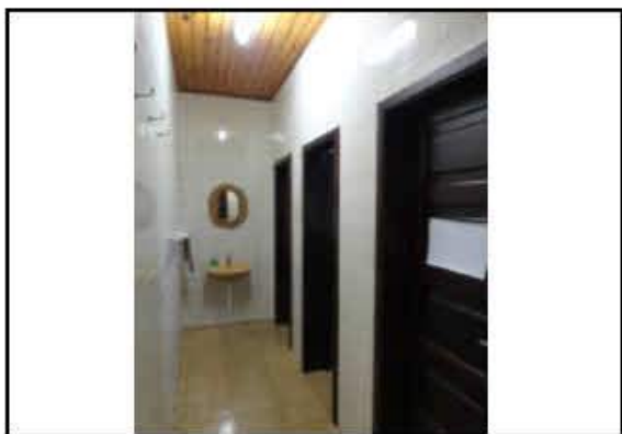
Detalhe de sanitário
