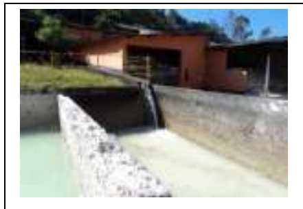
Processo de reciclagem de água
