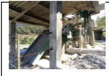
Estação de Tratamento de Efluentes
