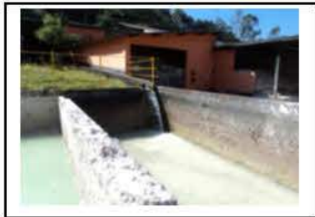
Processo de reciclagem de água
