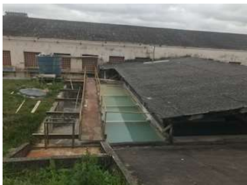
Sistema de limpeza e reaproveitamento de água
