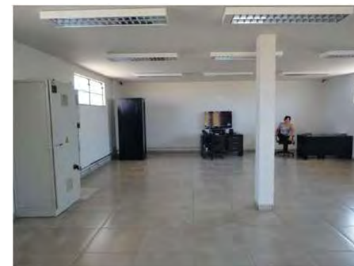
Sala de controle do terminal
