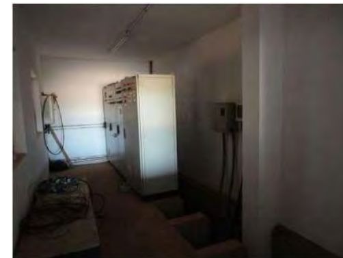
Sala quadro de comando
