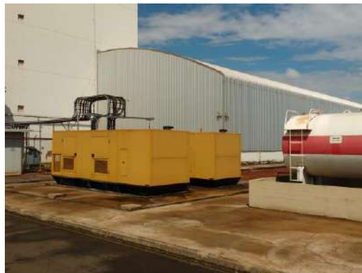
Gerador de energia
