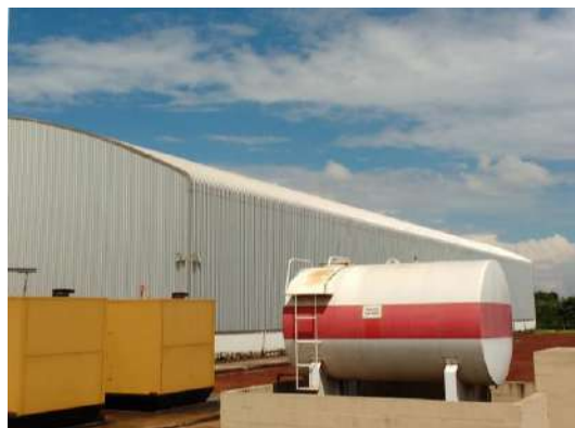
Tanque reservatório de óleo do gerador
