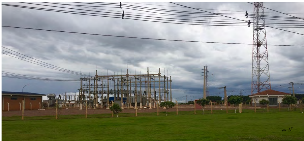
Estação de de Energia exclusiva da Enersul para o complexo Industrial
