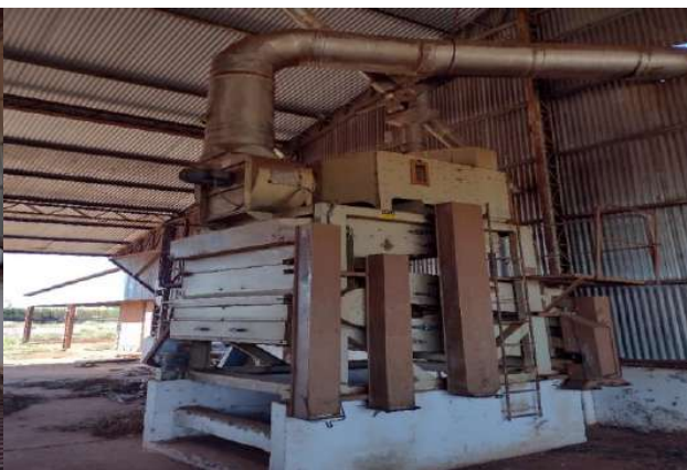
Equipamento de pré limpeza
