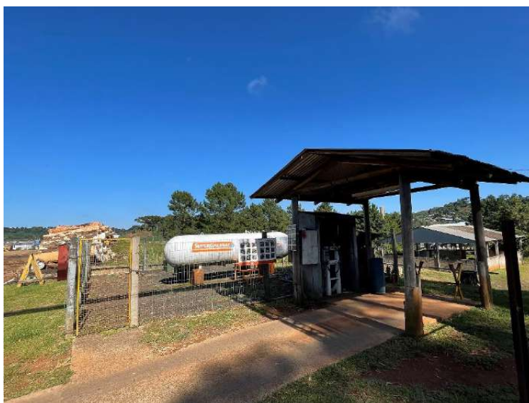
Figura 18 - Vista geral depósito de gás
