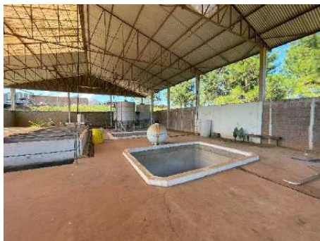
Figura 15 - Vista interna ETA 1
