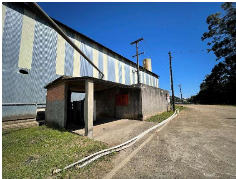
Figura 37 – Vista geral - Abrigo de transformador 1
