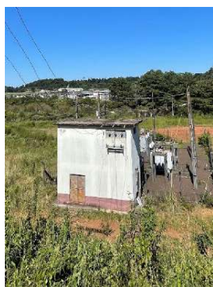
Figura 39 – Vista geral - Cabine de medição
