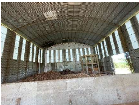
Figura 23 - Vista interna barracão caldeira
