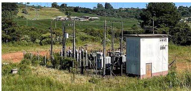
Figura 40 – Vista geral - Subestação elétrica
