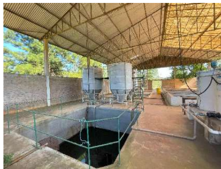
Figura 16 - Vista interna ETA 1
