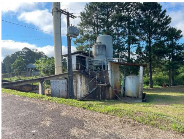
Figura 46 - Vista geral – ETA 2
