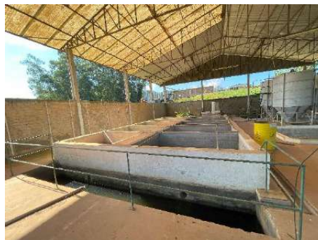
Figura 17 - Vista interna ETA 1
