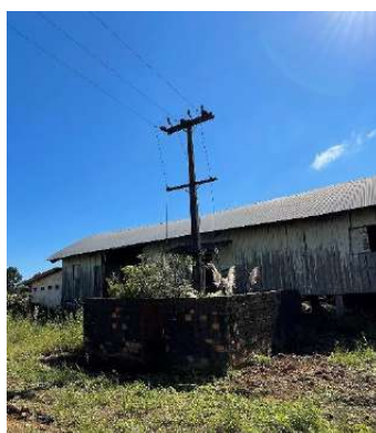
Figura 38 – Vista geral - Abrigo de transformador 2
