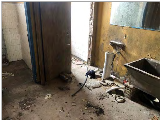
13. Detalhe de um banheiro totalmente depredado.
