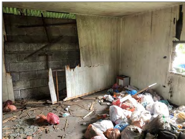
15. Detalhe de uma sala do mezanino com revestimento de madeira totalmente depredada e com acúmulo de lixo.
