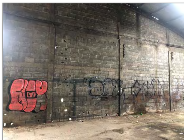
11. Detalhe da alvenaria de vedação com diversos buracos e infiltrações.
